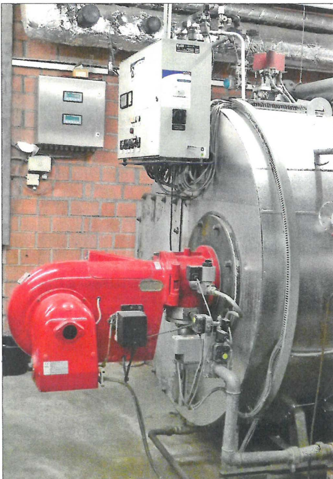
Zwei solcher Dampfkessel für die Wärmeversorgung kommen im Unternehmen vor allem im Winterhalbjahr unterstützend zum Einsatz.
